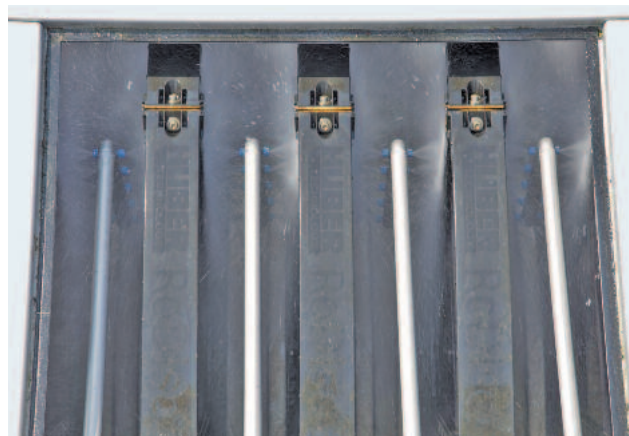
Filterplaadidelt rasvaemaldamine filtraadiga – pesuvett pole vaja väljastpoolt süsteemi sisse tuua
